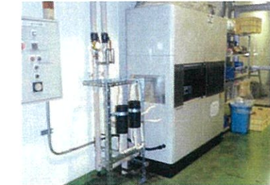
型式: 三菱電機 RWT-J425G (水冷式) 冷房専用機 空調機設定温度 28℃ α-HT設置工事日 2013年10月23日
